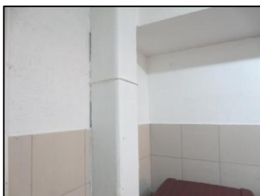
Photo N° 1280 AMIANTE CIMENT -- local VO -1 Murs Ventilation haute (Fibres-ciment)
